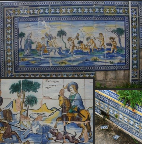
Painel da "Fonte" antes da intervenção (em cima) Destacamento e lacunas de vidro, colonização biológica (à esquerda) Floreiras antes da intervenção (à direita)
